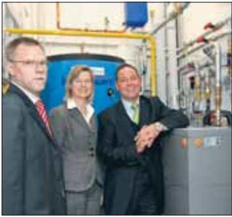
MVV-Vertreter Gerhard Fischer nahm gemeinsam mit Sero-Geschäftsführerin Beate Zientek-Strietz und Bürgermeister Hans-Jürgen Moos (v.l.) die Pilotanlage in Betrieb. Foto: privat
